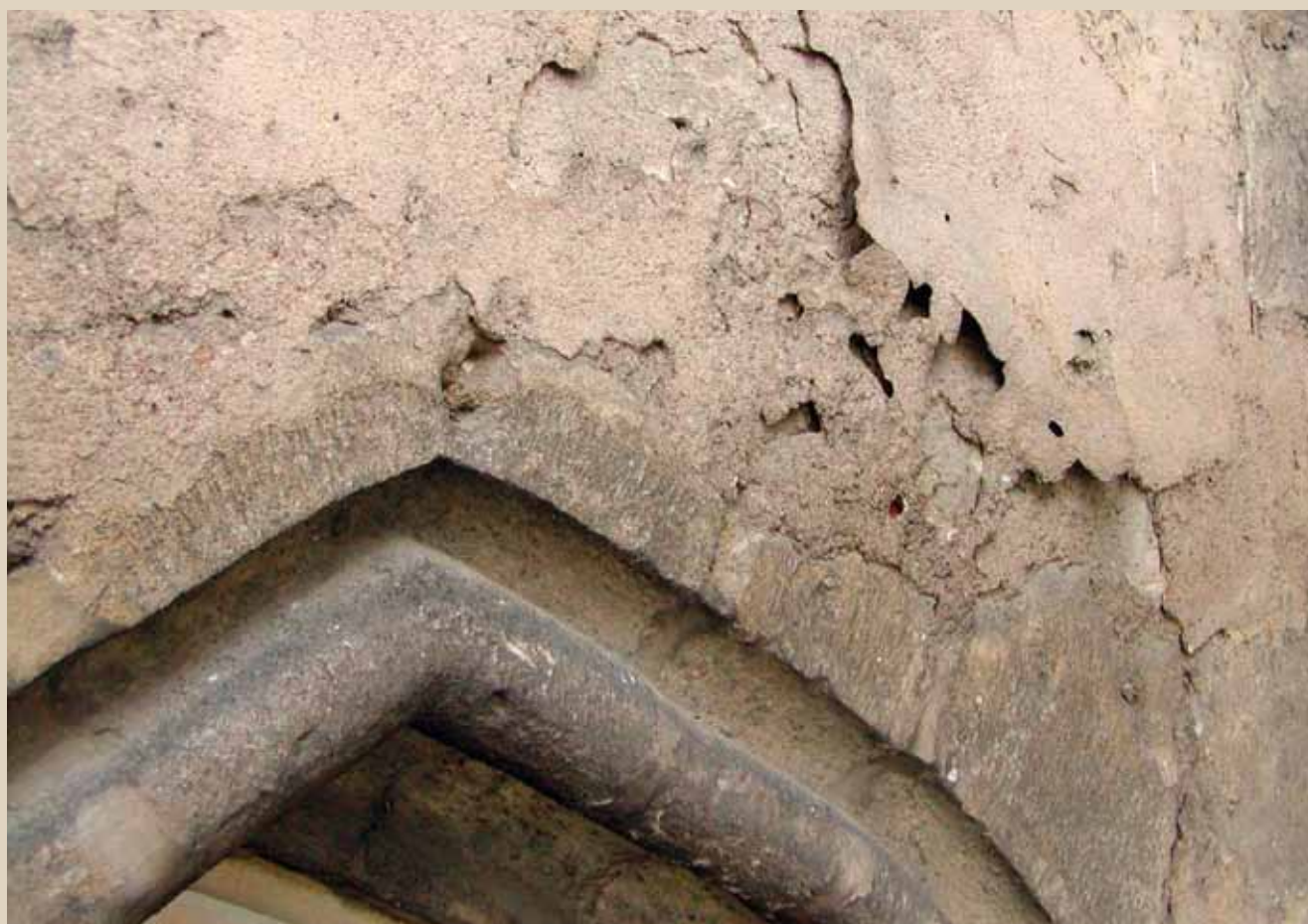
Detail degradace kamenného pláště
