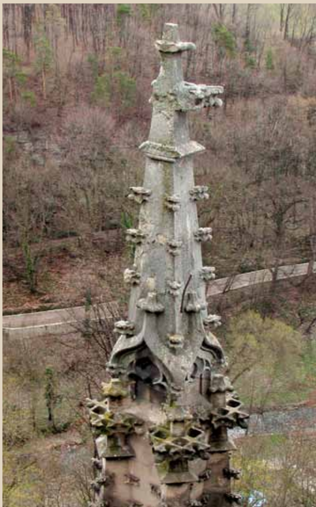
Gotická fiála – stav před restaurováním
