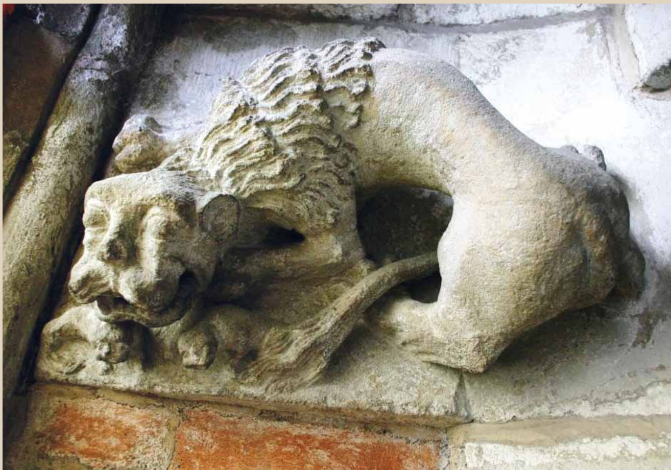
Kamenné prvky – stav před restaurováním
