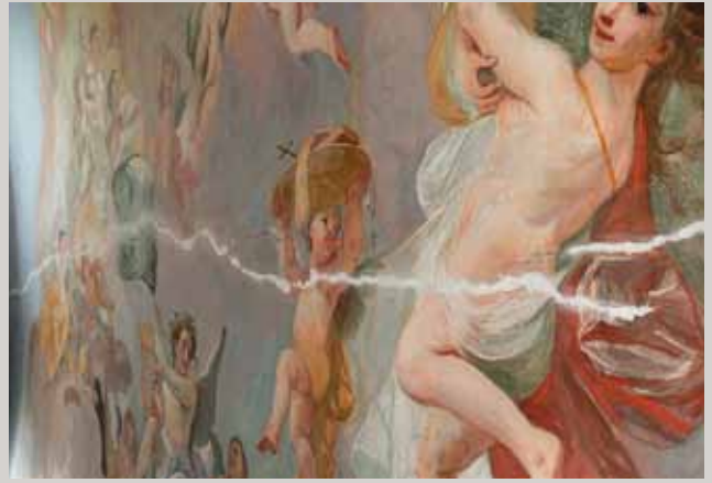
Zatmelená trhlina v klenbě přes postavy ve středové scéně
