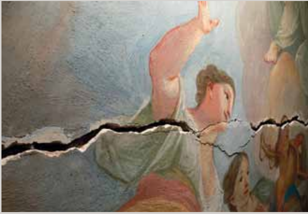
Trhlina v klenbě zasahující skupinu postav
