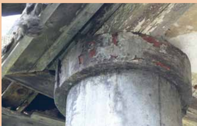
Detail sloupu – stav před restaurováním
