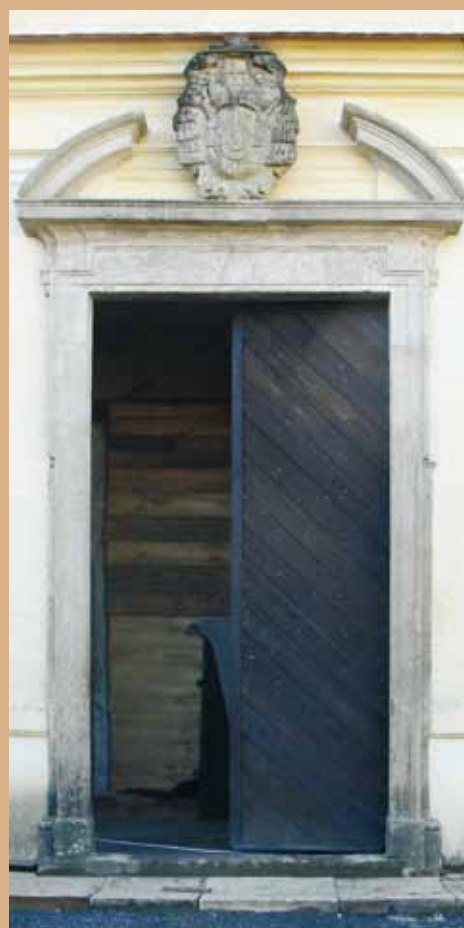
Kamenná supraporta – stav před restaurováním
