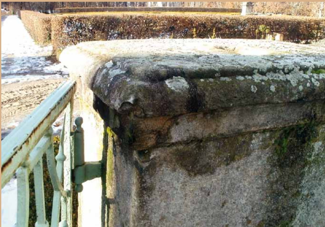
Detail historického zábradlí na nádvoří Květné zahrady – před restaurováním
