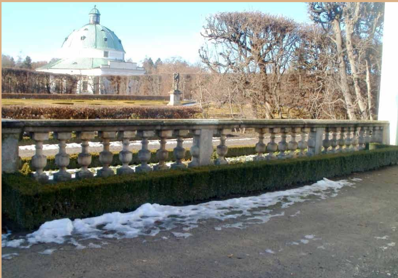
Celkový pohled na barokní balustrádu – stav před restaurováním
