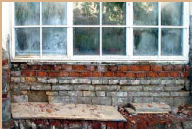
Stav oken u skleníku – před restaurováním
