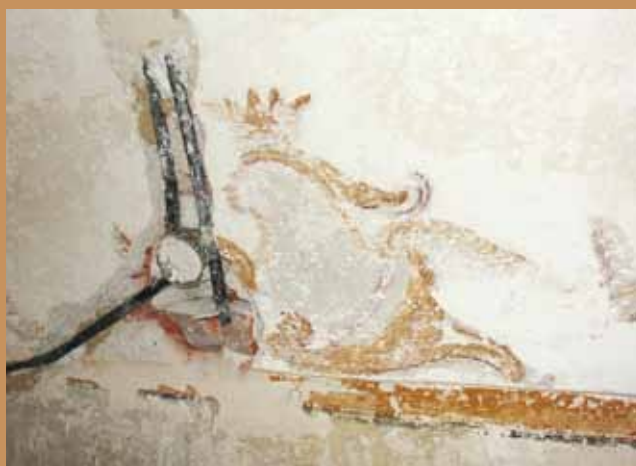
Poničení malby vlivem špatné elektroinstalace
