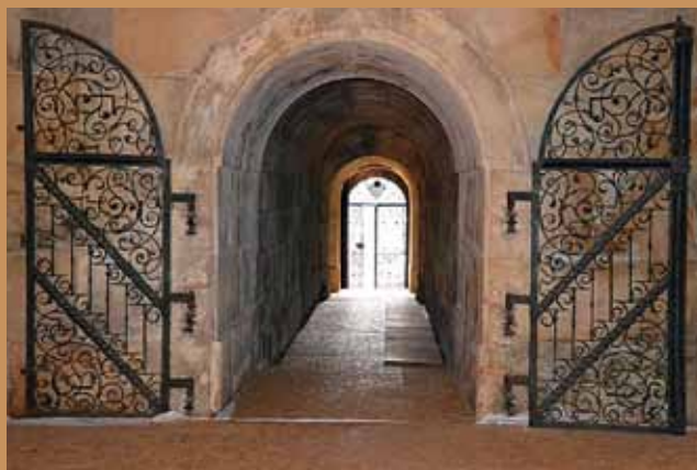
Kovaná vrata u vstupu do krypty – stav po restaurování
