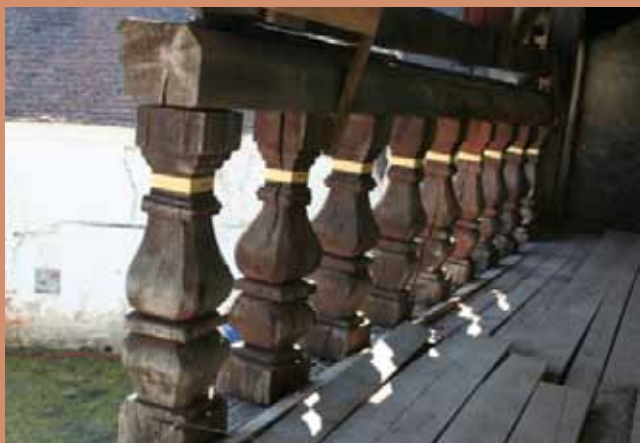
Dřevěná balustráda před restaurováním
