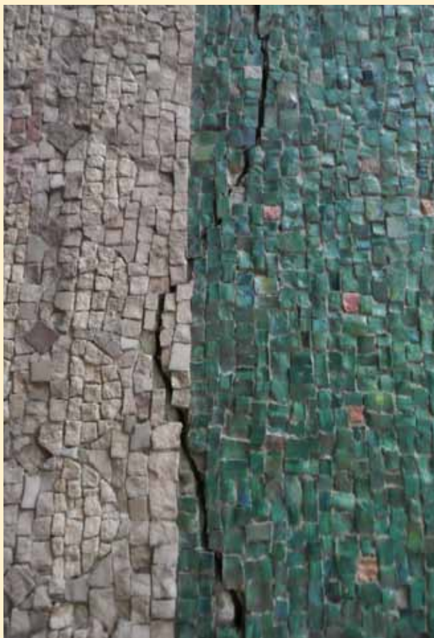
Síň Rudé armády – detail trhliny
