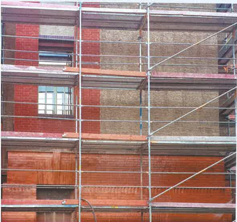
▼ Obr. 7 Pohled na rozpracované čištění lícového zdiva – v horní partii obrázku je patrná neočištěná část lícových cihel s nátěrem, ve spodní partii již zdivo po očištění lícových cihel abrazivní metodou TORBO
